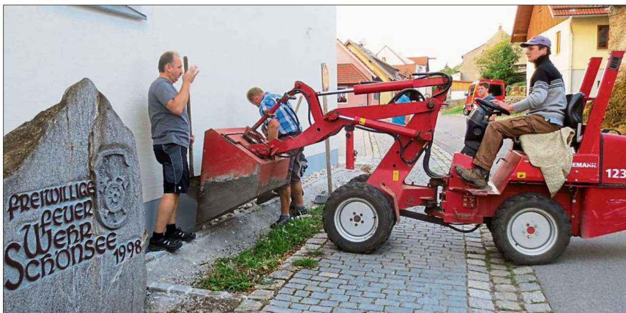
Mit großem Engagement haben die Mitglieder der Feuerwehr angepackt, um die Bausubstanz des Gerätehauses und das Gebäude optisch aufzuwerten.
