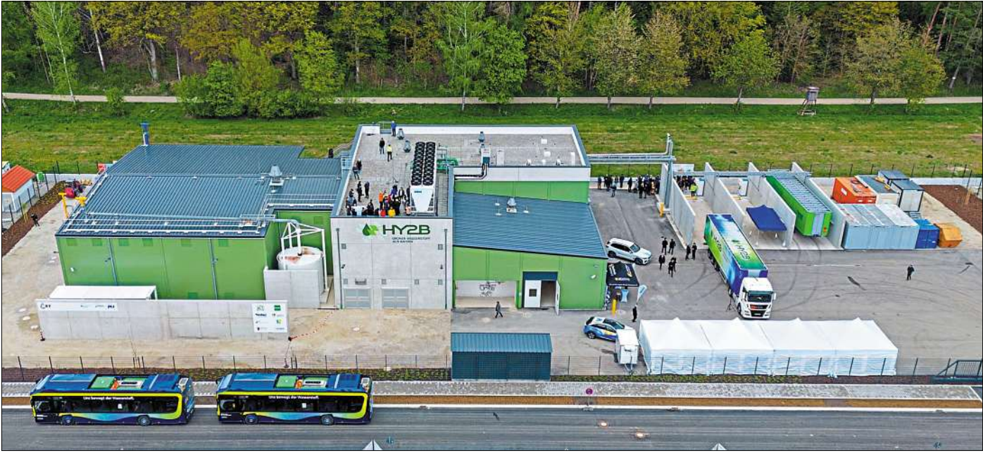
Der Elektrolyseur, der grünen Wasserstoff liefert, ist im April 2024 eröffnet worden. Er ist das Herzstück des Wasserstoff-Technologie-Anwenderzentrums (WTAZ).
